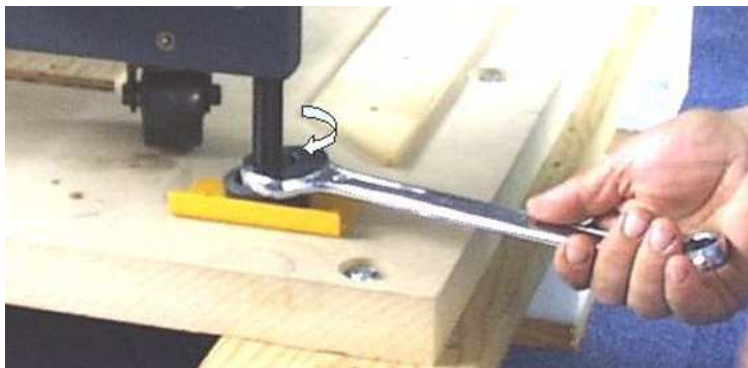
Figure 7. Abaissement des vis de calage de l'armoire
