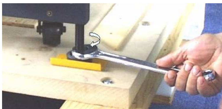
Figure 10. Abaissement des vis de calage – Armoire 36U
